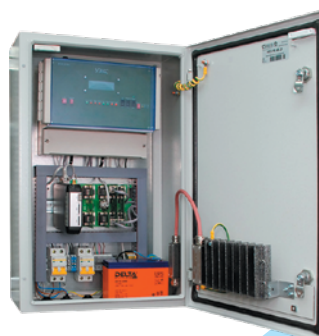
Шкаф запуска и контроля сирен (ШЗКС)
